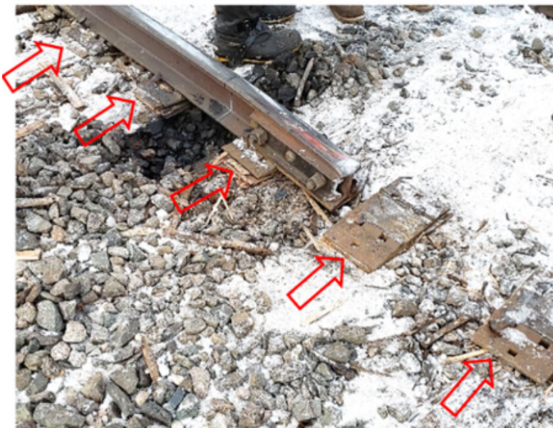
Figure 3. Extrémité ouest du joint rompu et des cales en contreplaqué sous les selles (Source : BST)
