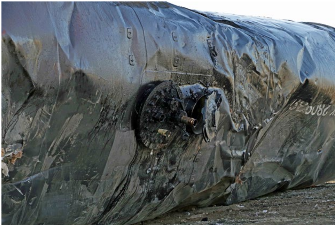
Figure 22. Dommages liés aux chocs sur le dessus du wagon VMSX 280939. Les 20 boulons retenant l'enceinte protectrice des raccords supérieurs au couvercle de la bride ont été cisailés, et l'enceinte protectrice s'est séparée du wagon. (Source : BST)
