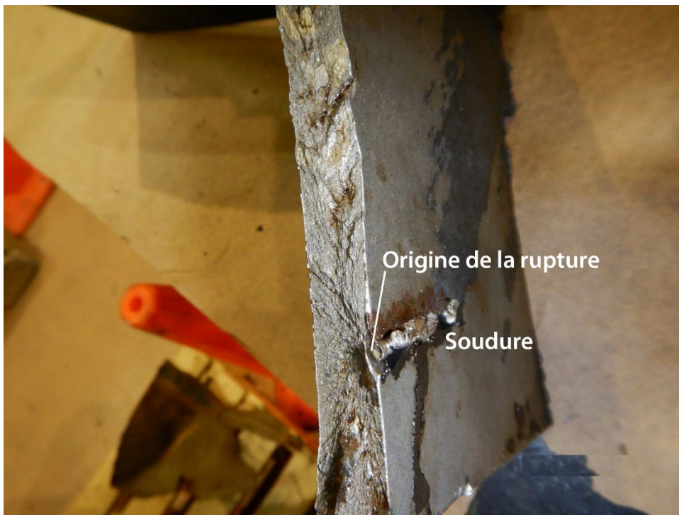
Figure 24. Soudure sur la surface de la pièce de raccordement de la longrine tronquée et origine de la rupture (Source : BST)
