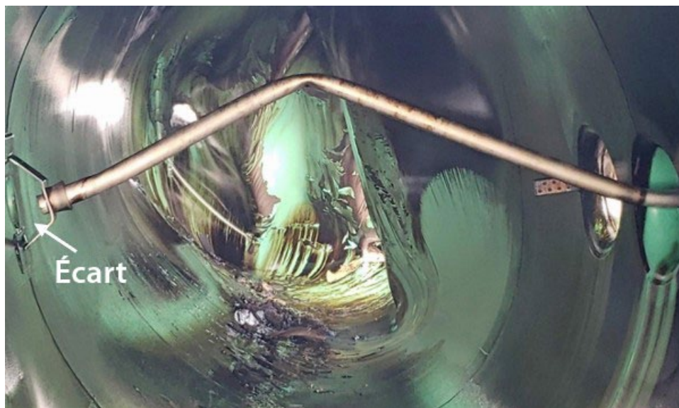
Figure 25. Photo in situ d'une tubulure de vidange endommagée, qui est sortie du puisard au bas de la citerne, à l'intérieur d'un wagon-citerne déraillé (Source : BST)
