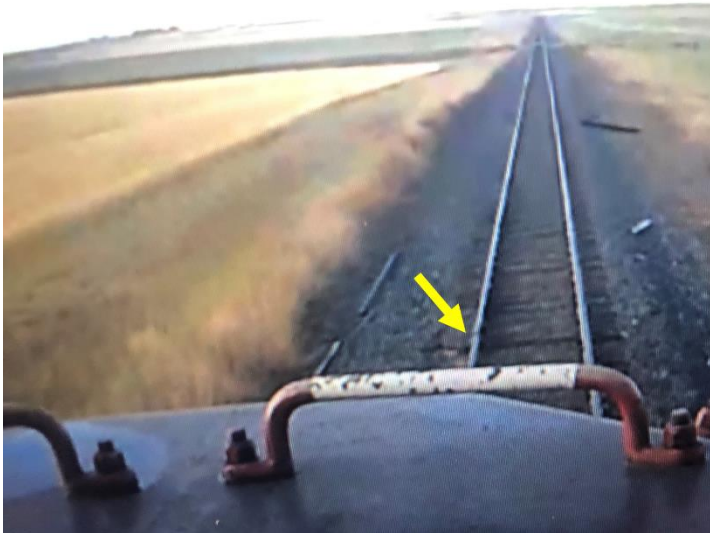
Figure 5. Vue avant montrant la rupture du rail Remarque : les bouts de rail sur la photo proviennent d'une précédente réparation de rail. (Source : Vidéo du Chemin de fer Canadien Pacifique)
