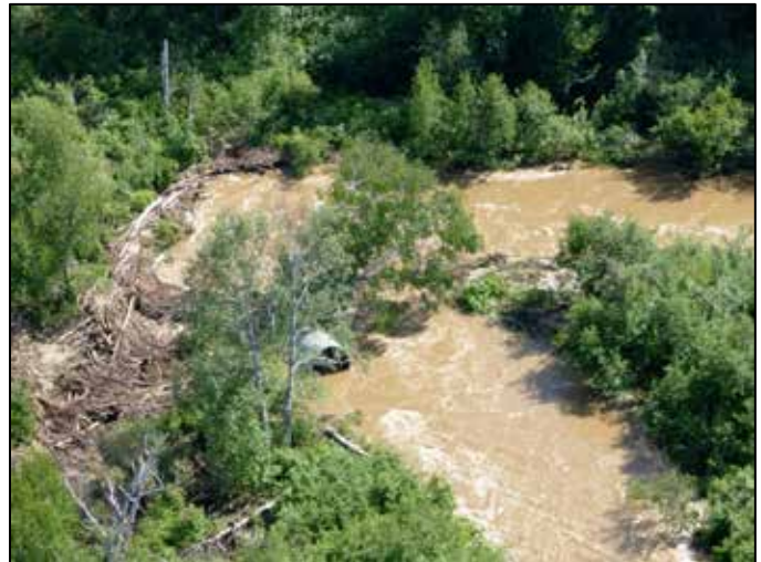
Figure 3. Ponceau routier emporté par les eaux avec débris
