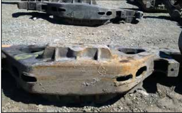
Photo 6. Éraflures sous le longeron d'un bogie du bout B du 62 e wagon
