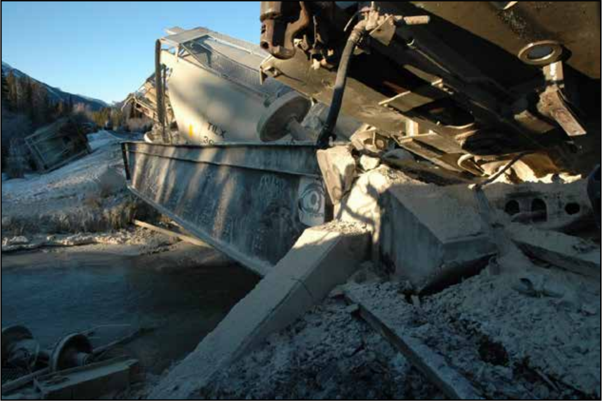
Photo 2. Wagens déraillés sur le pont
