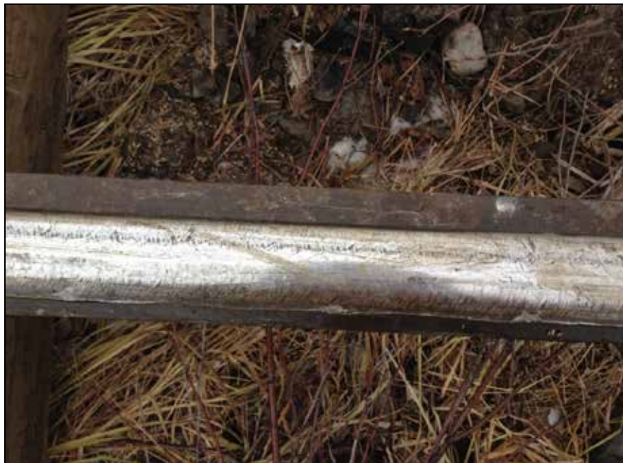
Photo 2. Marques de boudin de roue sur le champignon du rail bas
