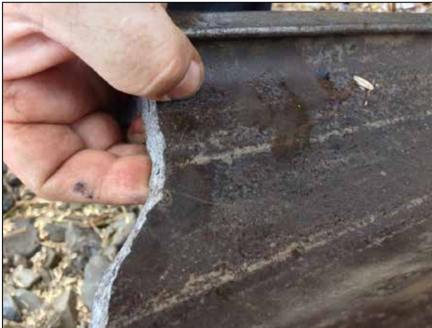
Photo 1. Marques de boudin de roue sur l'âme du rail haut
