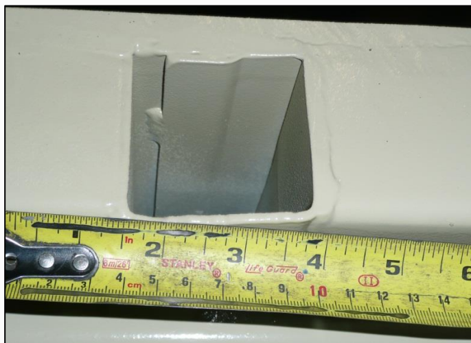
Photo 10. Tubulure utilisée pour l'ossature du toit. Revêtement du toit dans le haut de la photo (source : BST).
