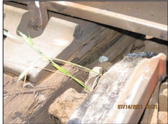
Photo 3d. Vue montrant une traverse entaillée par une selle sur le côté extérieur du rail bas, le polissage de l'appui de rail et le fendillement de la traverse
