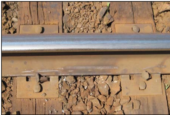
Photo 3a. Crampons du rail bas déformés et soulevés sur le côté intérieur du rail bas au PDD
