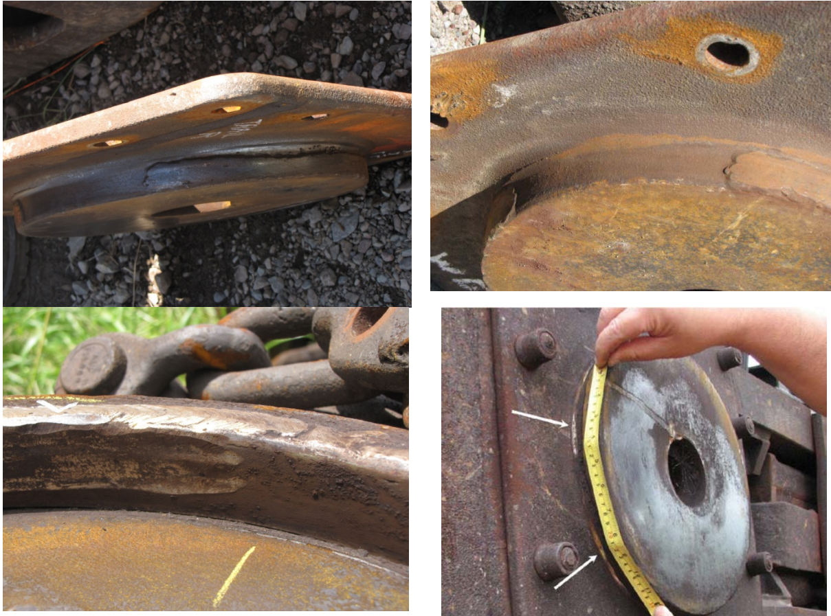
Photo 3. État des pivots sur le wagon PROX 98433 - Surface verticale reconstruite au moyen d'une soudure (photos supérieures droite et gauche); gougeage de la bague d'usure de la crapaudine du bogie à l'emplacement correspondant (photo inférieure gauche); et marques brillantes autour de la plaque d'assise (flèches) dues au contact avec la crapaudine du bogie (photo inférieure droite).
