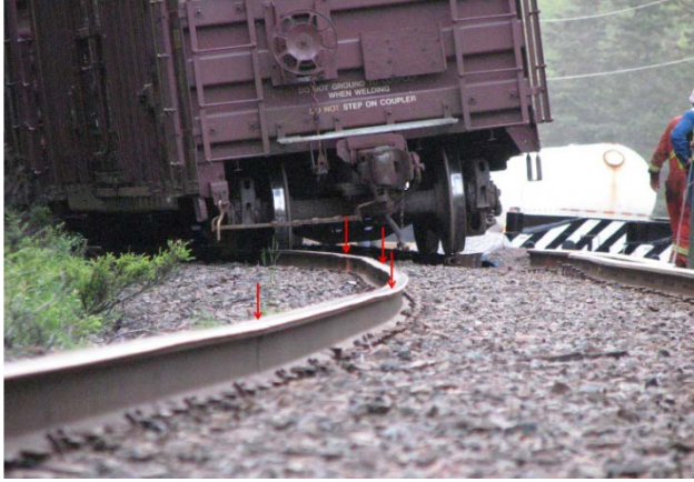
Photo 4. Vue du point de déraillement. Les flèches indiquent les endroits où le rail était aplati.
