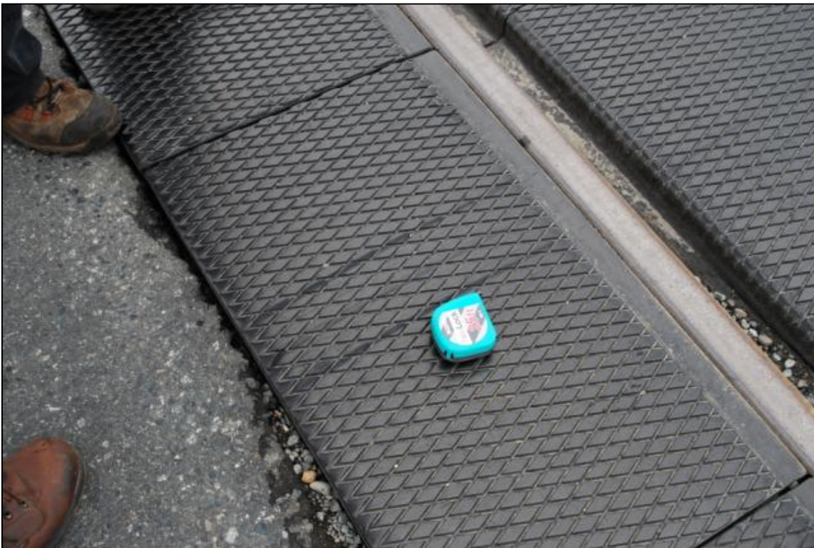
Photo 1. Marques de pneu du côté ouest du passage à niveau
