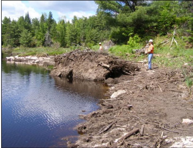
Photo 4. Partie déplacée d'une digue de castor
