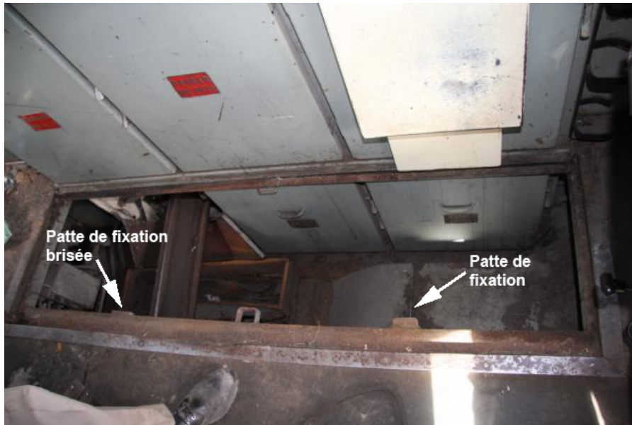
Photo 2. Vide sous les panneaux de plancher
