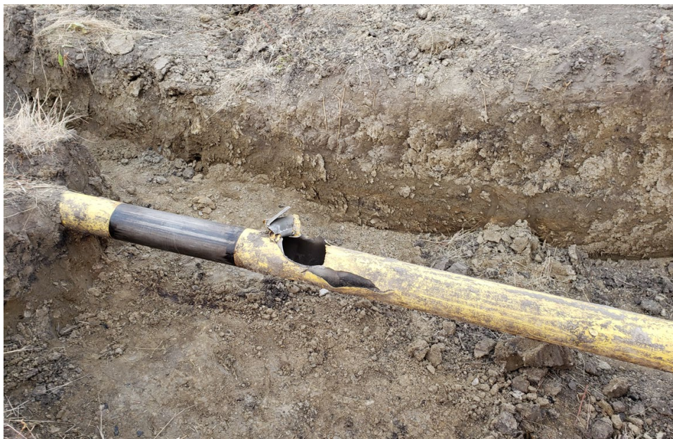
Figure 4. Zone excavée montrant la section endommagée du pipeline (Source : BST)
