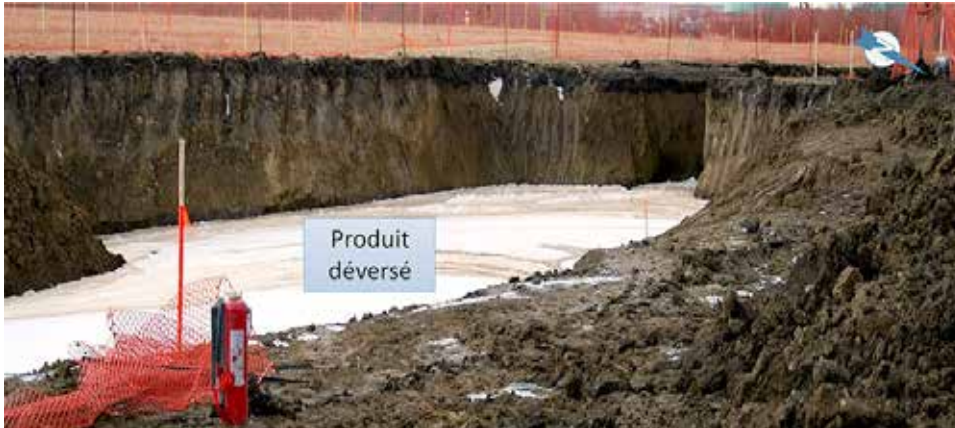
Figure 4. Excavation existante contenant le produit déversé
