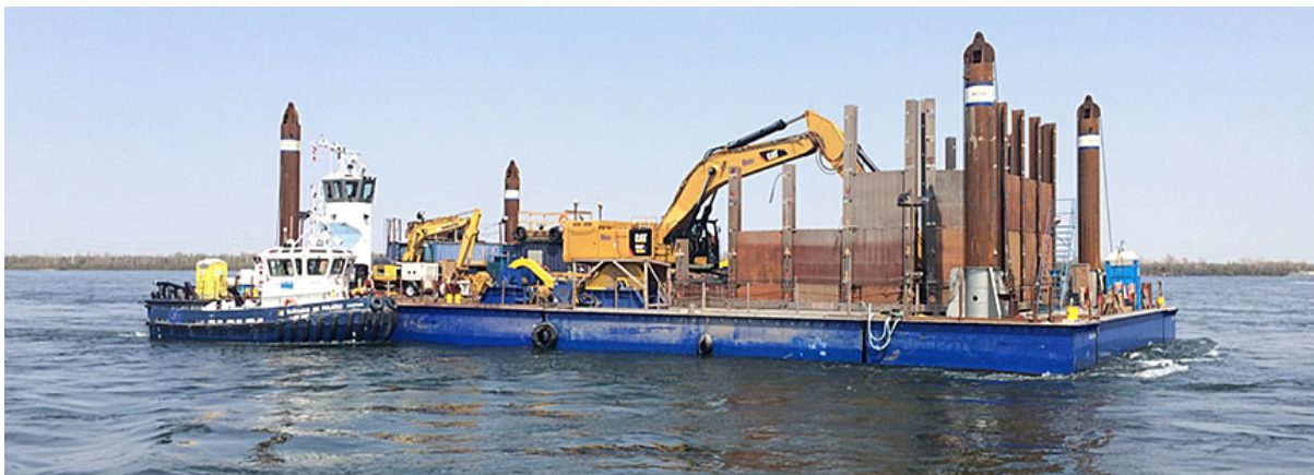
Figure 11. Chaland flanqué de remorqueurs (Source : Groupe Océan)
