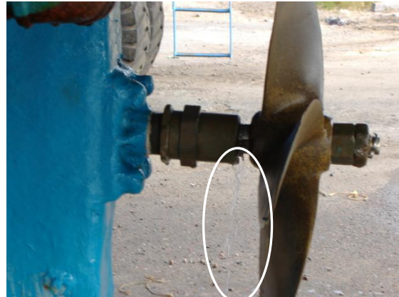
Photo 4. Presse-étoupe laissant fuir de l'eau après le sauvetage du bateau
