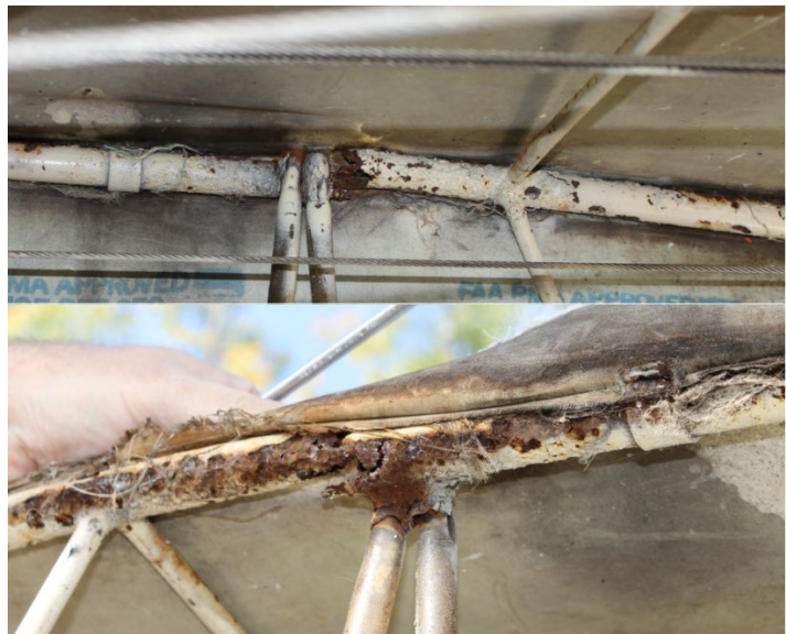
Figure 3. Photos sous 2 angles différents de la structure tubulaire en acier sous la batterie sectionnée sous l'effet de la corrosion (Source : BST)
