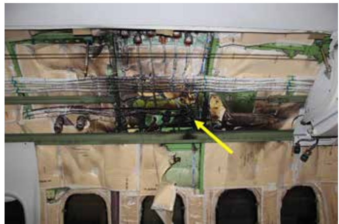
Figure 2. Zone endommagée par la chaleur à la rangée 14 de l'aéronef en cause après dépose du garnissage de la cloison gauche de la cabine (la flèche pointe sur le connecteur 9811-J711)
