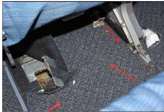
Figure 11. Plancher endommagé devant le siège passager 33D
