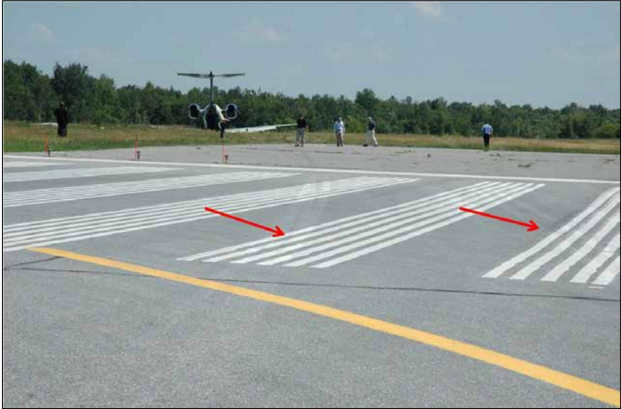
Photo 2. Marques de chauffage à la vapeur observées à l'extrémité départ de la piste 07
