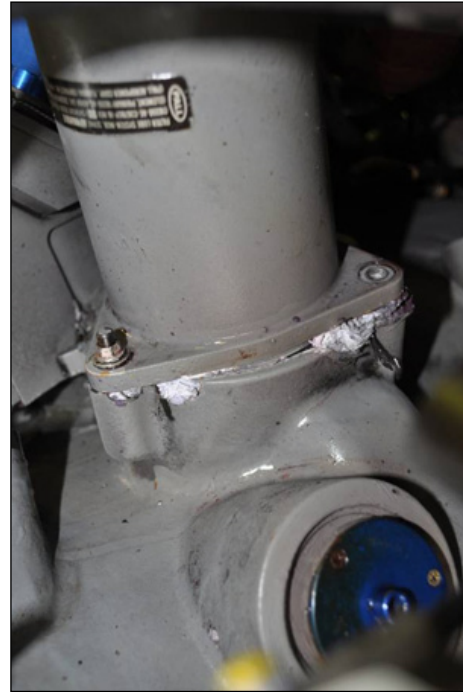
Photo 7. Cuve du filtre à huile du CHI91
