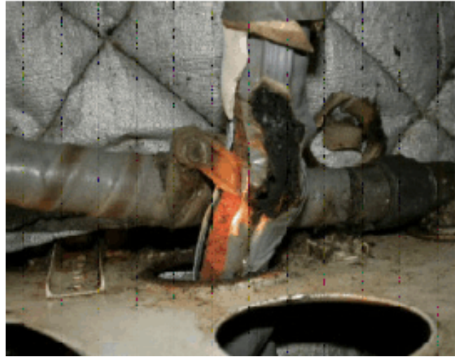
Photo 5. Ruban chauffant brûlé derrière la paroi arrière
