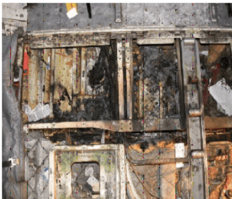
Photo 1. Zone endommagée par le feu
