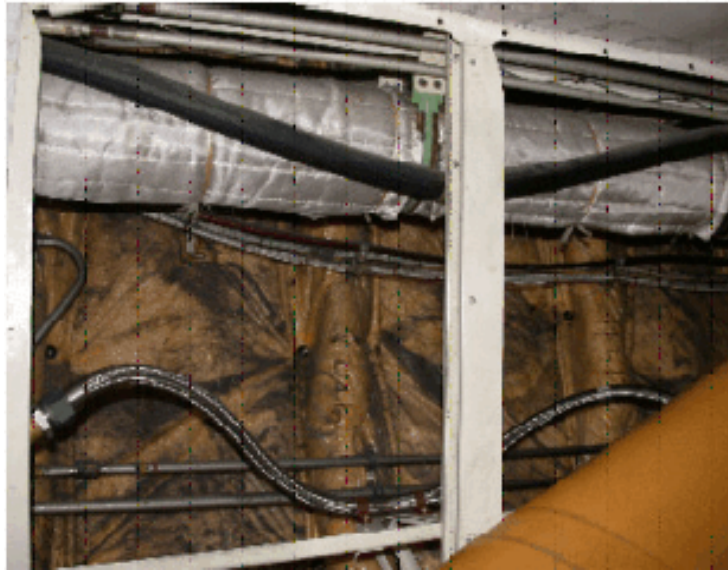
Photo 7. Accumulation de poussière et de peluche sur l'isolant thermique et acoustique derrière le panneau de paroi
