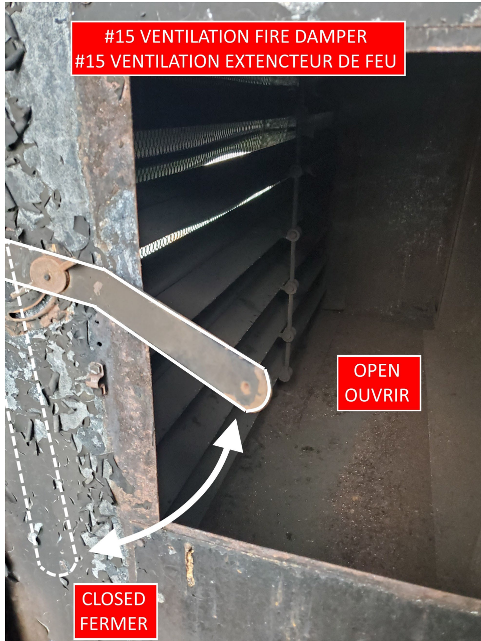
Figure 13. L'événement 15, avec la poignée du volet en position ouverte et un panneau d'accès retiré. Les étiquettes représentent l'emplacement et l'aspect des plaquettes d'identification qui ont été détruites par l'incendie. (Source : BST)
