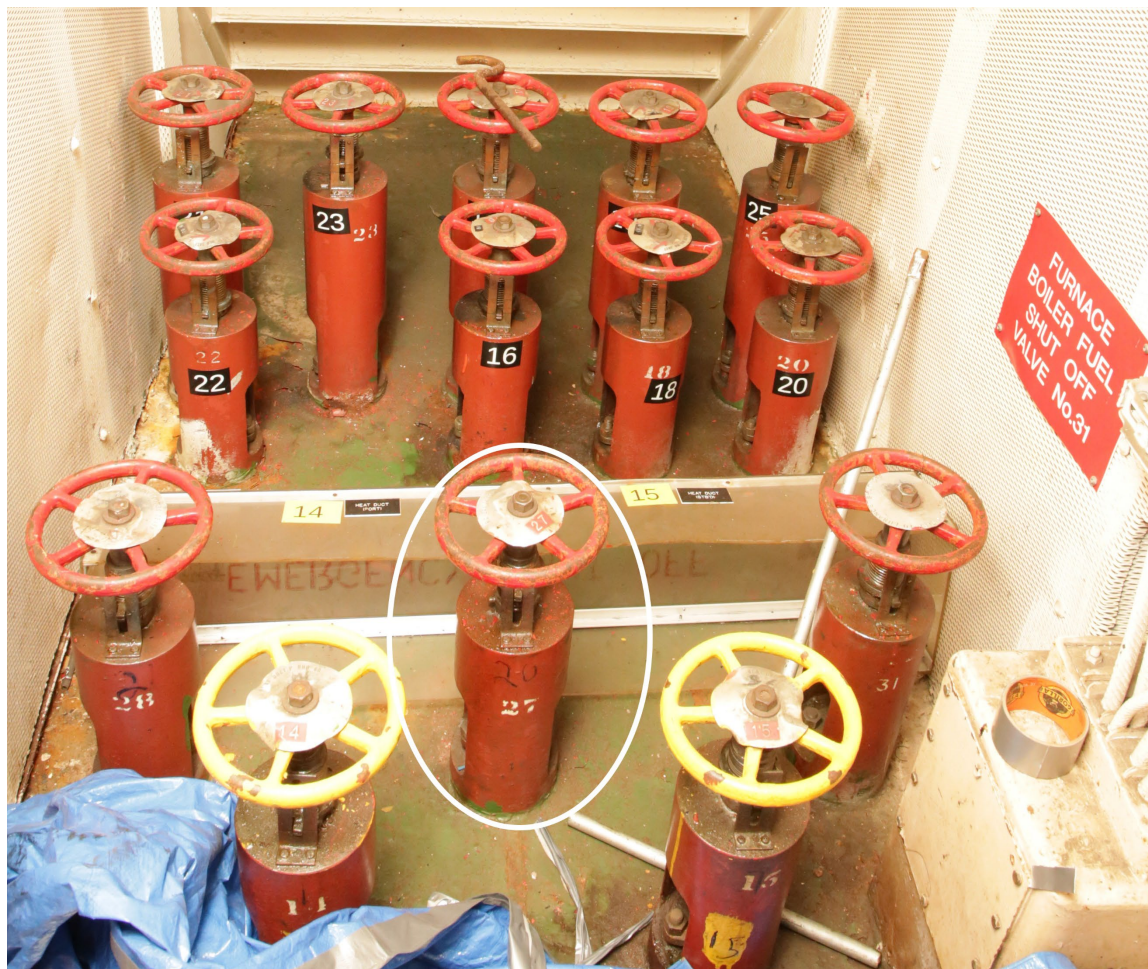
Figure 10. Tiges de manœuvre des dispositifs d'arrêt de l'alimentation en carburant dans le compartiment du pont principal. La tige de manœuvre qui ferme le robinet de carburant des deux machines principales est encerclée en blanc. (Source : BST)
