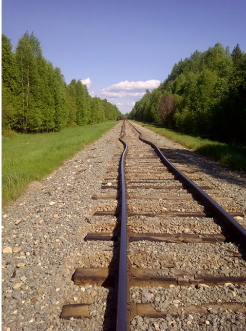
Figure 6. Flambage de la voie (Source : Rapport d'enquête ferroviaire R14E0081 du BST)
