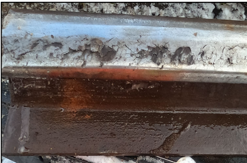
Figure 3. Rail rompu récupéré, présentant des criques du champignon (Source : BST)
