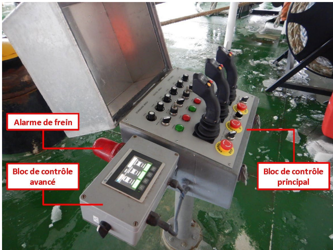
Figure 6. Vue d'ensemble du poste de commande des treuils d'amarrage arrière (Source : BST)
