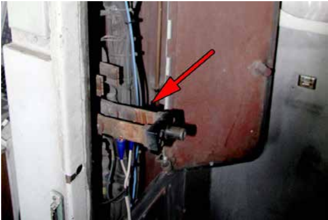
Figure 5 : Sectionneur électrique principal
