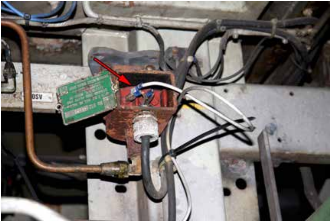
Figure 3 : Raccordement en vue de l'essai de frein sur la locomotive 5017
